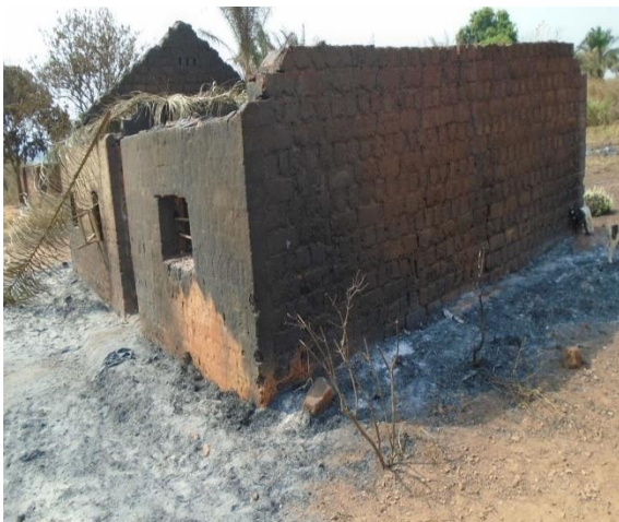
Photo d'une maison victime d'incendie suite au feu de brousse dans le secteur de Karawa
