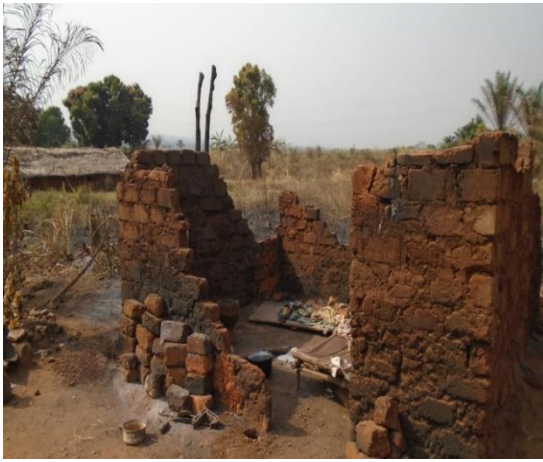
Photo d'une maison victime d'incendie suite au feu de brousse dans le secteur de Bodangabo
